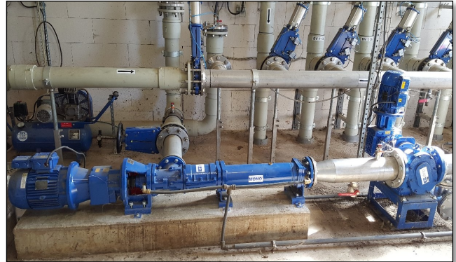
Z36B + Broyeur CT201D : transfert digestat - 10m 3 - 3 bars
